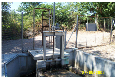
(b) Vanne automatique sur le Canal de Gignac (source : P-O. MALATERRE)
